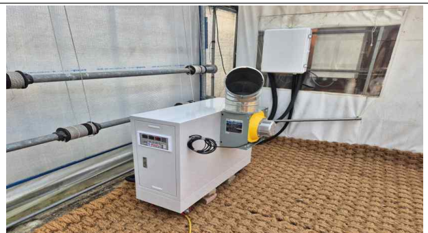
육묘하우스 전기 온풍기 설치
