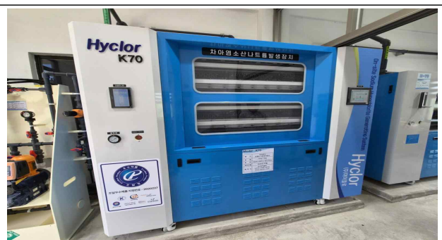
거창정수장 차염발생기(교체 후)
