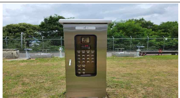
(구)배수지 제어반(교체 후)
