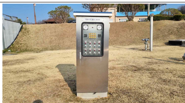
(구)배수지 제어반(교체 전)
